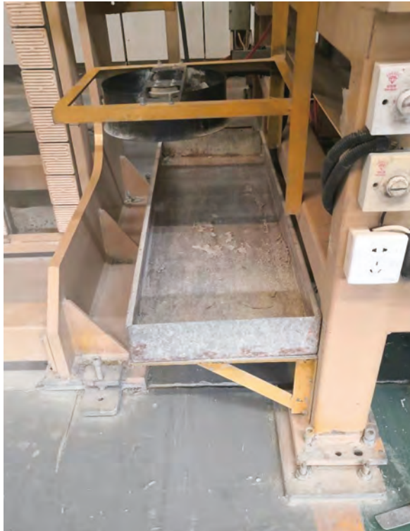
泥料回收裝置
